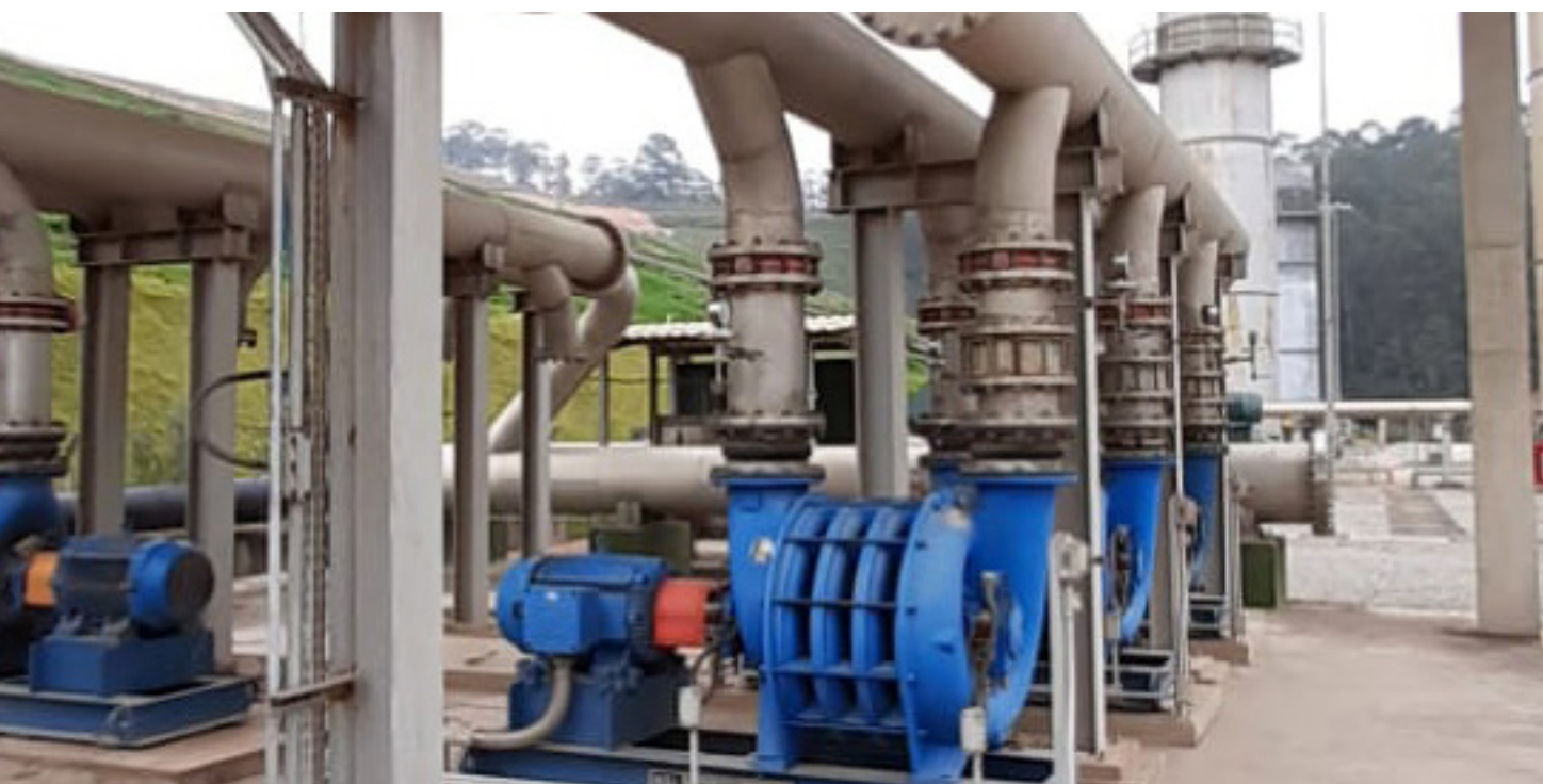
Vista parcial dos equipamentos para tratamento do biogás antes dele ser usado em usinas termoeletricas ou queimado em flares
