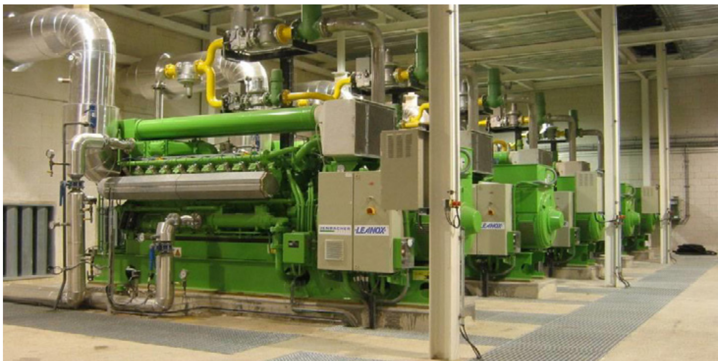
Motogeradores de usina termoeletrica que usa como combustivel o metano
