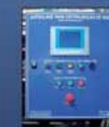
Controlador Lógico Programável (CLP) - Monitoramento do processo e repetibilidade; - Sistema de supervisão; - CLP Siemens com Tela Touchscreen.
