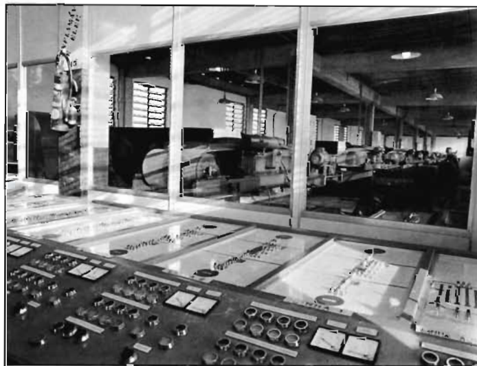
Usina de V Leopoldina: painel de comando.
