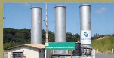
Estação de tratamento de biogás - primeiro certificado de crédito de carbono (CER) no Brasil
