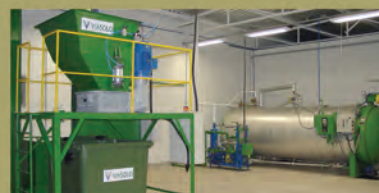
Autoclave. Tratamento de resíduos de serv. de saúde
